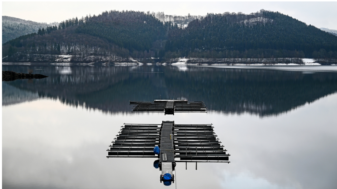
Die Stege aus den 70er Jahren müssen in Schuss gehalten werden, sonst drohen Unfälle. Peter Kramer taucht regelmäßig mit einem Kollegen darunter.
